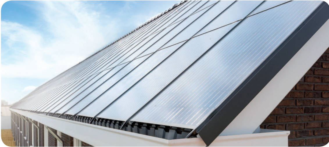
FIGUUR 13: ZONNEPANELEN OP HET DAK
